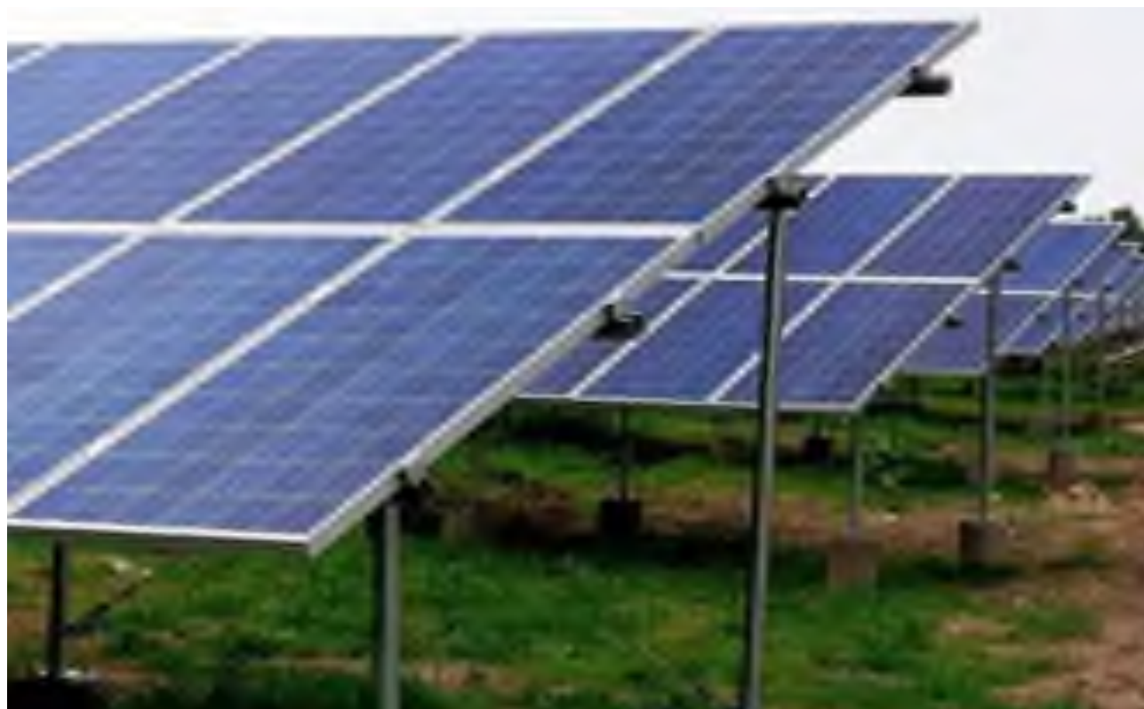
Câmp cu panouri fotovoltaice
